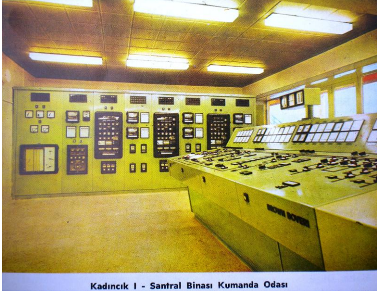
Kadıncık I - Santral Binası Kumanda Odası
