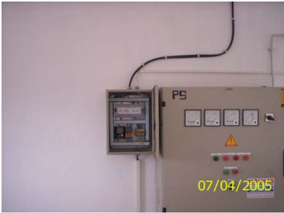
Şekil-11. Dalgıç pompa kontrol PIC PLC
