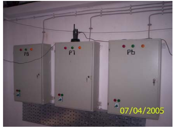
Şekil-12. Yatay pompa panoları ve RF data telsizi
