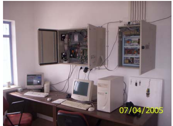
Şekil-14. Kontrol PC ve PIC PLC kontrol panosu
