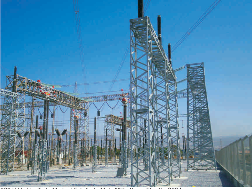
380 kV Işıklar Trafo Merkezi Fotoğraf : Mak. Müh. Yavuz Efeoğlu-2004
