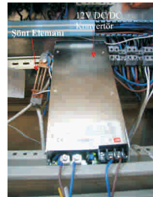
Şekil 11. Şönt elemanı ve 12V DC/DC konvertörün görünümü
