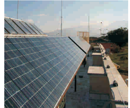
Şekil 2. Çatıda kurulu fotovoltaik paneller
